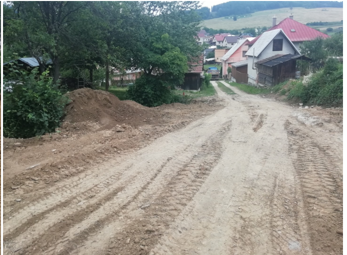
stav po sprejazdení
